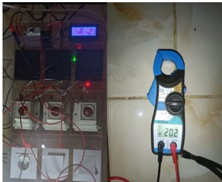
Gambar 4. Pengukuran Tegangan menggunakan Sensor PZEM-004T dan Alat Ukur Multimeter
