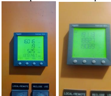
Gambar 3. Foto tegangan sebelum dan sesudah di suplai Kota Nopan
