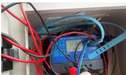
Gambar 25 (b) : Hasil Pengukuran Pada Akumulator di Solar Charge Controller (SCC)
