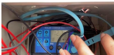
Gambar 24 (b) : Hasil Pengukuran Pada Panel di Solar Charge Controller (SCC)
